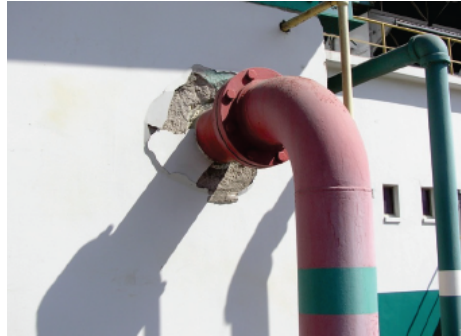
벽체 관통배관 파손 1994년 Peru 지진(Eduardo Fierro)
