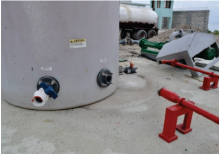
고정되지 않은 소화수조의 이동에 따른 배관연결부 파손, 2010년 Haiti 지진(Eduardo Fierro)
