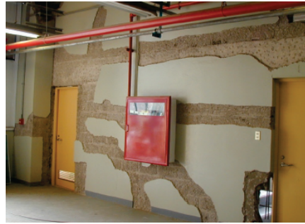
조적벽에 설치된 함 파손 2001년 Peru 지진(FEMA 74, 2012)
