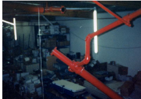
버팀대 파괴에 따른 소화배관 파손 1994년 미국 Northridge 지진(FM Global, 2010)
