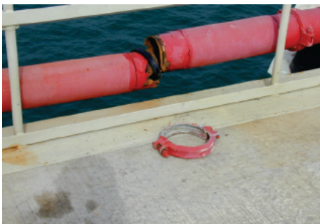
배관 연결부 파손 2001년 Peru 지진(FEMA 74,1994)
