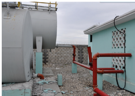
소화수조 전도 및 배관연결부 파손 2010년 Haiti 지진(Eduardo Fierro)
