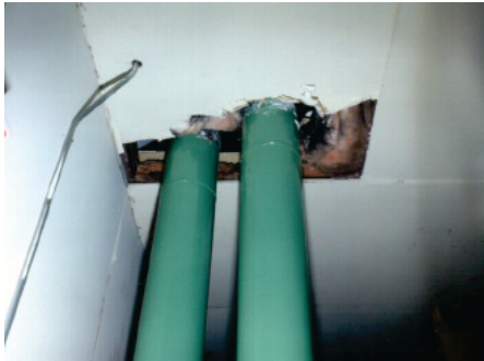
입상관 파손 1994년 미국 Northridge 지진(Mason Industries)
